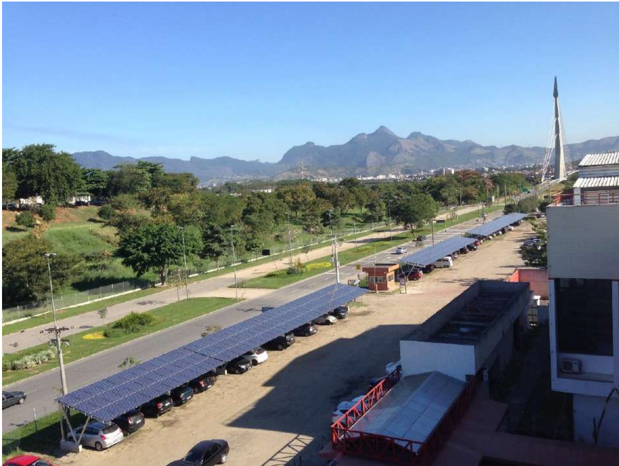
Sistema fotovoltaico UFRJ • Créditos: Fundo Verde
